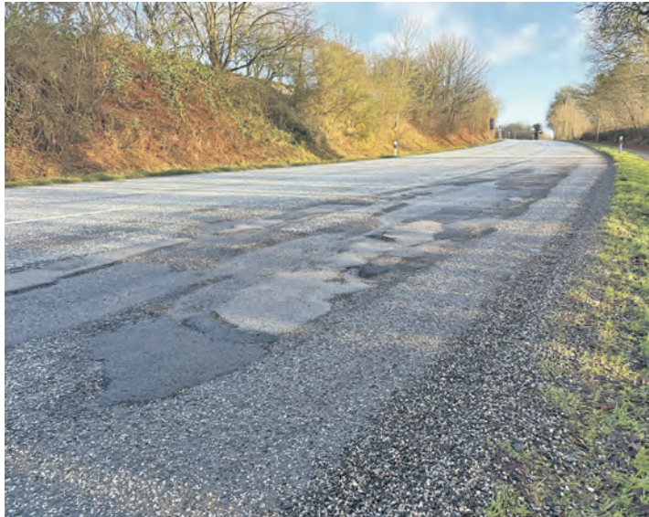
Seit anderthalb Jahren wartet diese kleine Schadhafte auf Instandsetzung.
