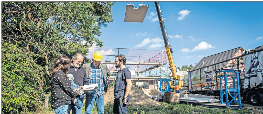
Baugrund ist in vielen Regionen heiß begehrt. Vor dem Kauf sollte man genau hinschauen, welche Baugrundrisiken es gibt. (Foto: djd/Bauherren-Schutzbund)
