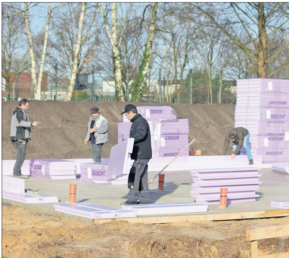
Eine Bodenplattendämmung verhindert Wärmeverluste und sollte zur Neubauplanung eines Eigenheims in jedem Fall dazu gehören. (Foto: djd/Jackon Insulation)
