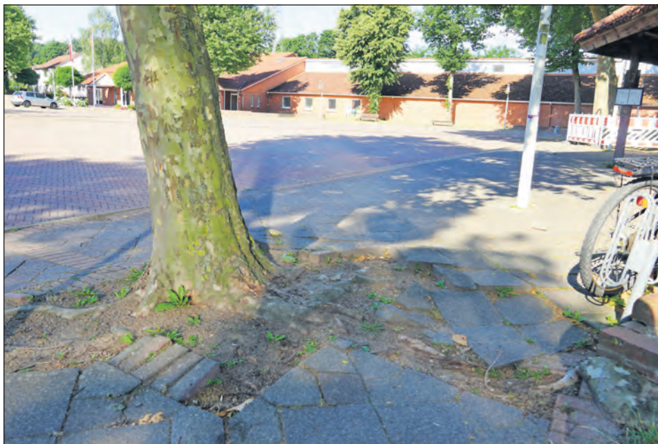
Die Gehwege, insbesondere im Bereich der Bushaltestelle, befinden sich in einem desolaten Zustand.
