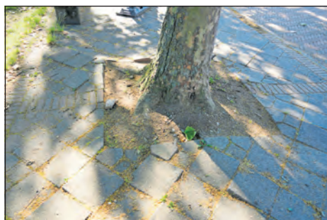
An vielen Stellen kommen die Pflastersteine hoch und werden zu Stolperfallen.
