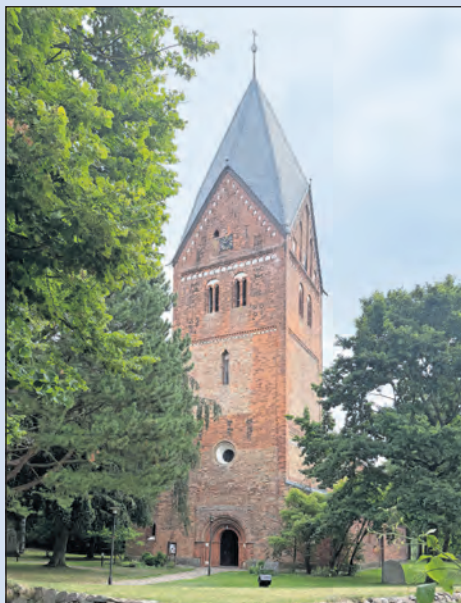
Wahrzeichen der Region: Allein die Sanierung des Daches von Turm und Kirchenschiff wird nach erster Schätzung rund 2,5 Millionen Euro kosten.
