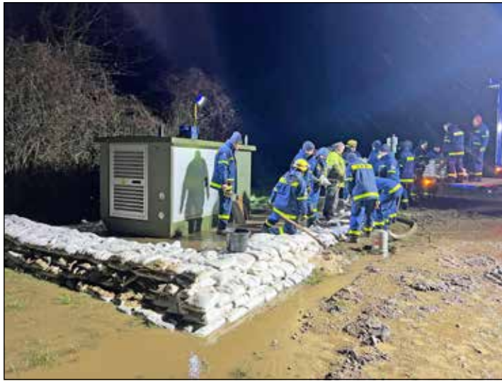
Am 3. Januar mussten die Aktiven des Preetzer THW in Belau eine Trafostation mit Sandsäcken vor der Überflutung schützen. Foto: hfr
