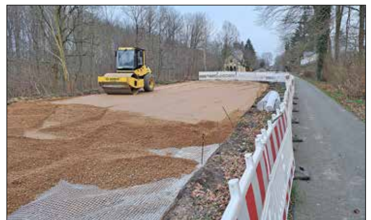
Zwischen Schellhorn und Sophienhof wird auch der Baugrund erneuert. Die Fahrbahn wird schmaler als vorher gebaut. Fotos: Graap
