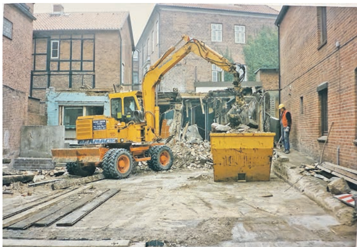
Nach einem Brand konnte die „alte“ Eisenpfanne, Lange Straße 51 nur noch abgerissen werden.
