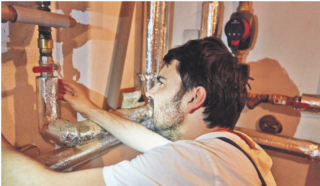
Kleine Schritte, große Wirkung: Durch die Dämmung von Heizungsrohren und Warmwasserleitungen im Keller lassen sich Energieverluste relativ einfach reduzieren. Foto: Robert Kneschke – Shutterstock
