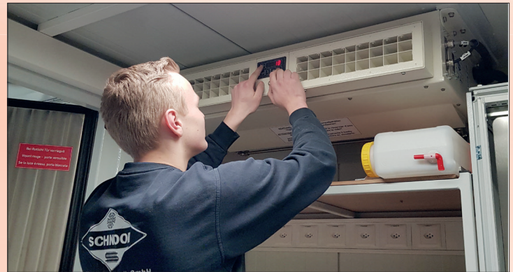
Seit über fünf Jahrzehnten ist die Firma Schnoor führend in Sachen Kühltechnik. Hier wartet ein Mitarbeiter eine Klimaanlage.
