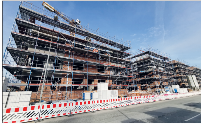
Auf dem Baggersand in Travemünde entstehen bis Anfang nächsten Jahres 254 bezahlbare Wohnungen.
