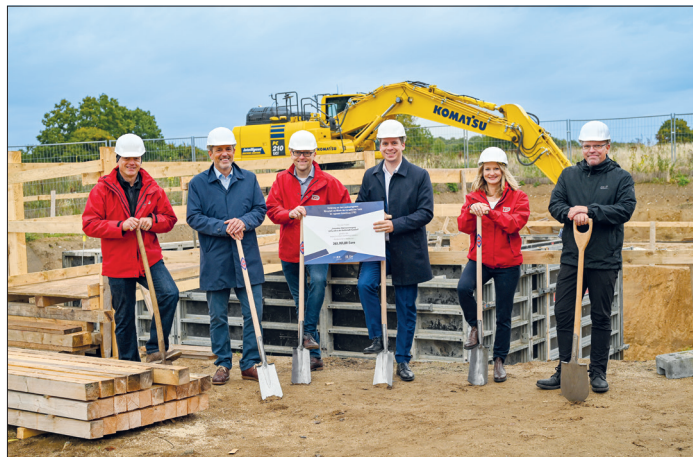
Übergabe des Förderbescheids (v.l.): Torben Scheuch (Mitarbeiter und am Projekt beteiligt ZVO Energie GmbH), Thomas Keller (Bürgermeister Ratekau), Jost Glüsing (ZVO Energie GmbH – Projektleiter und Zitatgeber), Frederike Muhs (ZVO Energie GmbH, Leiterin Vertrieb und Marketing), Frank Spreckels (Verbandsvorsteher ZVO). Fotos: ZVO/hfr
