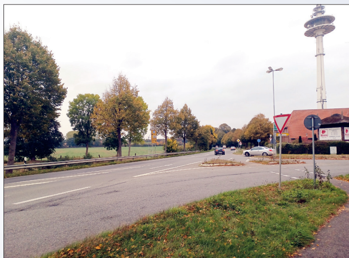
Am kommenden Montag beginnen in Stockelsdorf die Arbeiten zum Ampelbau an der Einmündung der Pohnsdorfer Landstraße zur Ahrensböcker Straße.
