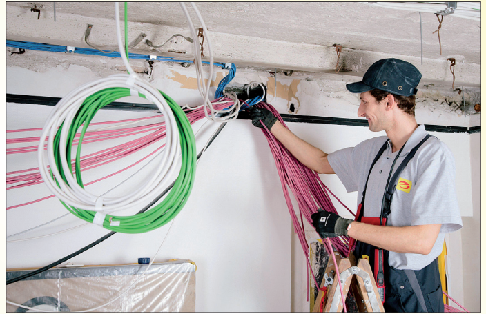
Alle Sanierungsarbeiten an der Elektroinstallation sollte eine Elektrofachkraft begleiten und vornehmen. Werkfoto: ZVEH
