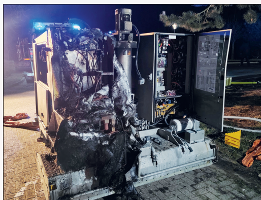
Die vom Feuer zerstörte Eisaufbereitungsmaschine – wie es zu dem Brand gekommen ist, ist Gegenstand der Ermittlungen der Kripo.
