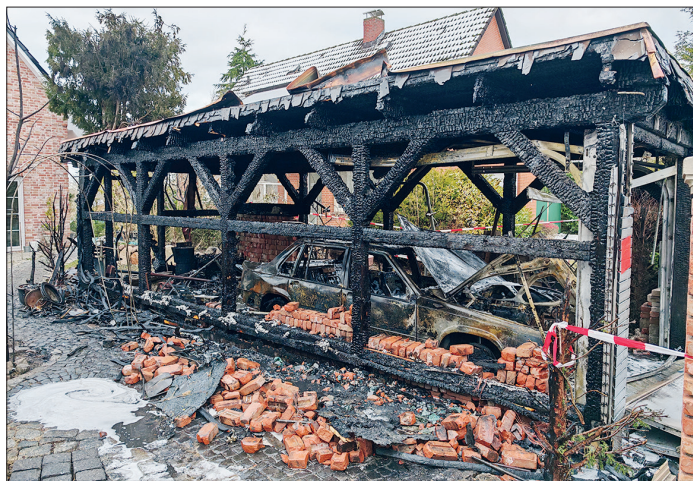
Im Tageslicht wird das volle Ausmaß des Feuers sichtbar. Der gasbetriebene Volvo im Carport ist komplett ausgebrannt.
