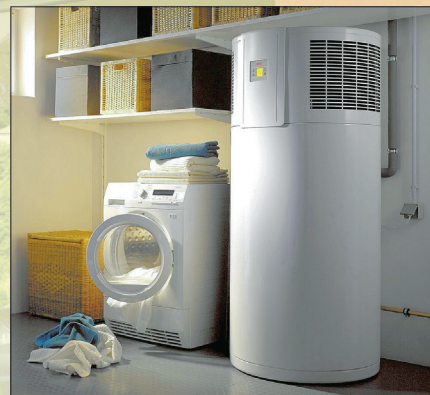
Besonders wirtschaftlich: Warmwasser-Wärmepumpe in Kombination mit einer Photovoltaikanlage. Werkfoto: AEG/Wärme+
