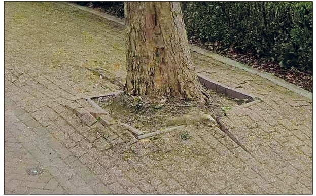
Hier ist gut zu sehen, wie sehr die Wurzeln die Pflastersteine um den Baum herum und auf den Wegen zu den Häusern der Anwohner hochdrücken.
