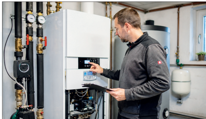
Nicht warten, bis die Heizung streikt – lieber jetzt an die Wartung denken. Ein Termin beim Heizungsfachbetrieb gehört zu den sinnvollen Vorbereitungen auf die kalte Jahreszeit. (Foto: KI)
